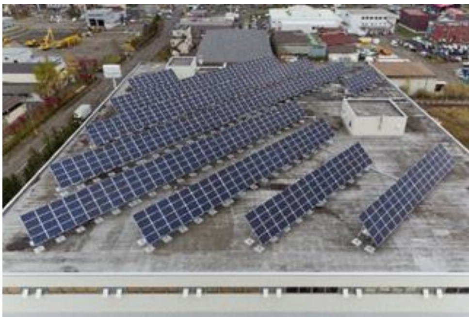
太陽光発電設備（札幌通運(株) 大曲倉庫）
